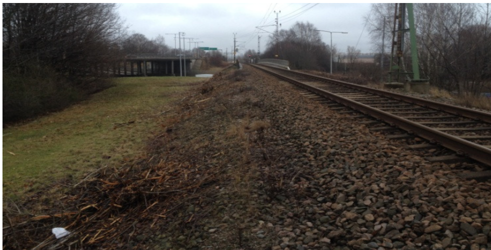
Foto 1. Järnvägsbanken intill det norra brofästet
